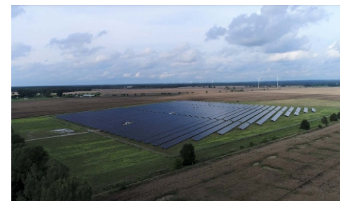
Solkraftwerk in Weesow
